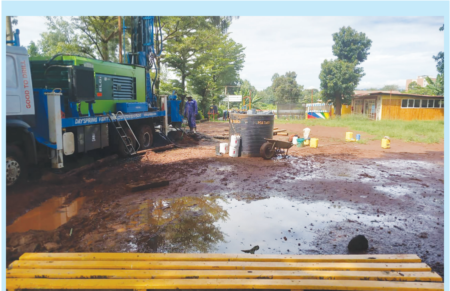
Es war nicht ganz einfach, den Lastwagen mit der Bohreinrichtung zwischen den Bäumen und den Bänklein der Schulkinder an den richtig Ort zu manövrieren. Im Hintergrund ist der Kindergarten zu sehen.
