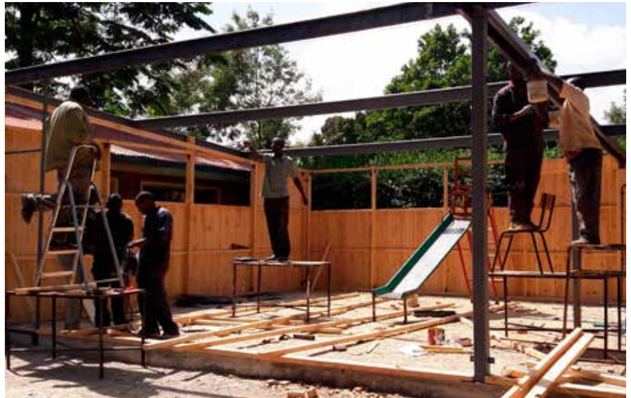
Nicht ganz Suva-konforme Baugerüste, aber zum Glück ist nichts passiert.
